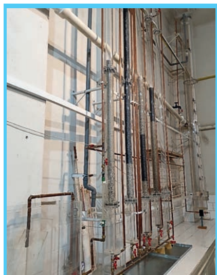
Componentă stație de tratare - Coloane de filtrare, adsorbție
