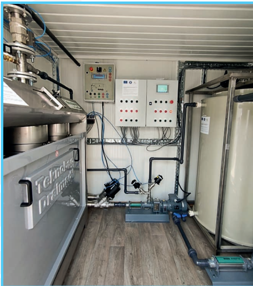
Instalație pilot de tratare, recuperare și valorificare a nămolului și a levigatului aferent
